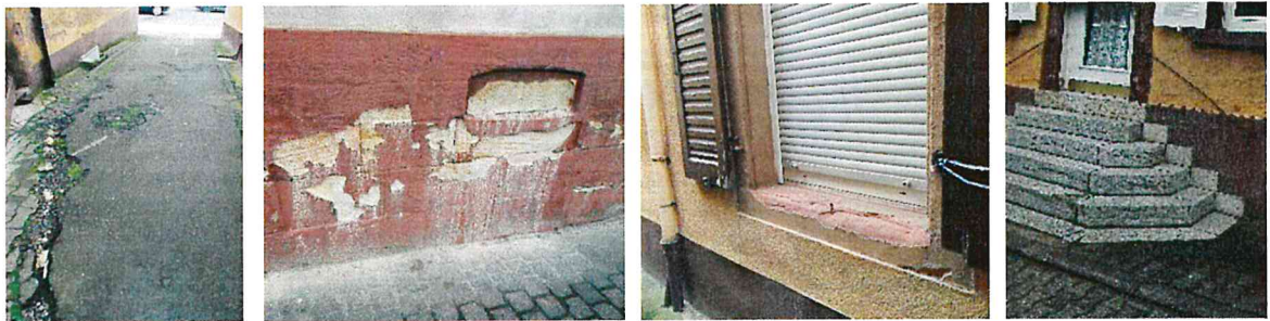
Bilder: Details Sanierungsbedarf (Quelle: WSW & Partner)
