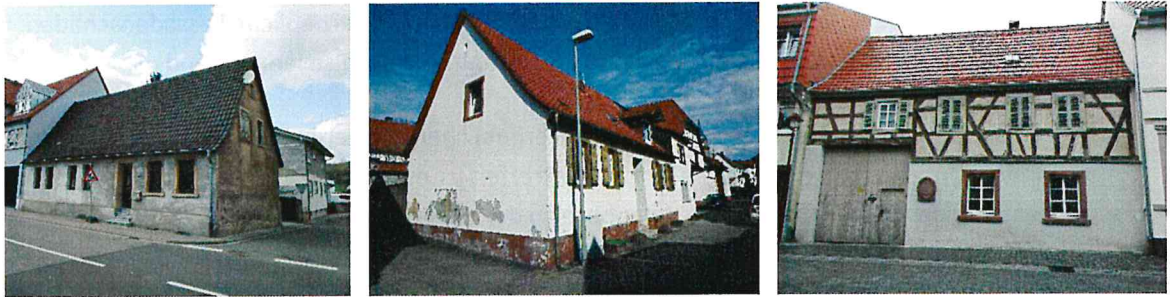
Bilder: Gebäude mit Sanierungsbedarf (Quelle: WSW & Partner)
