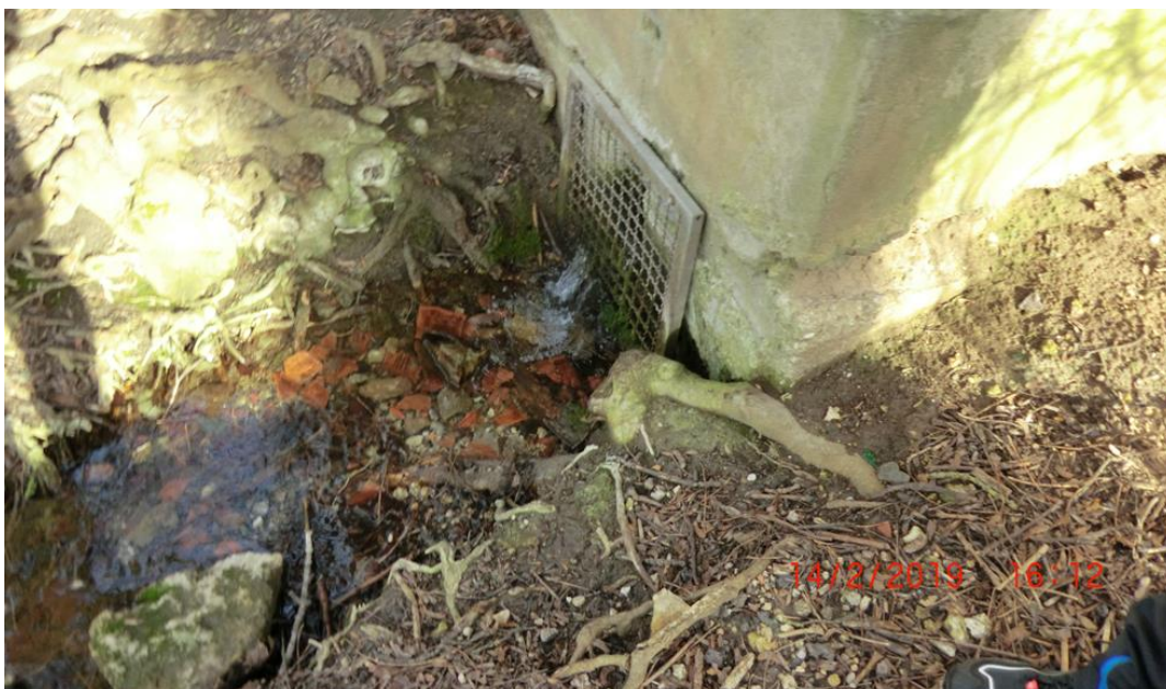
Abbildung 60: Bsp. Einlaufbauwerk mit Unterhaltungsbedarf
