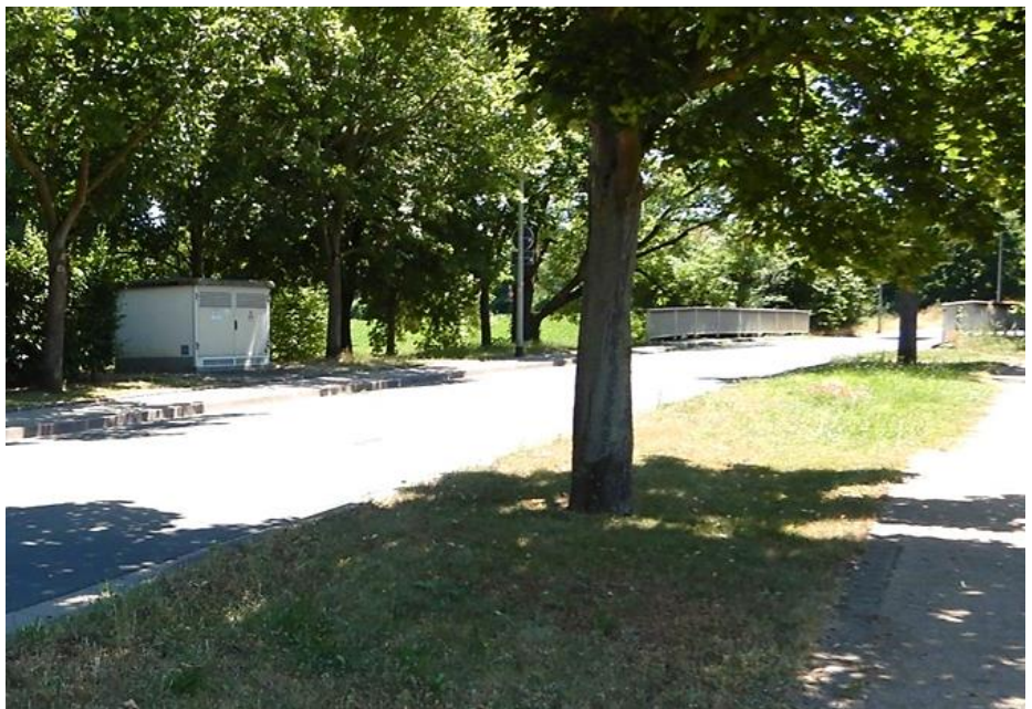
Abbildung 17: Trafostation in Albisheim an der Unteren Bahnhofstraße
