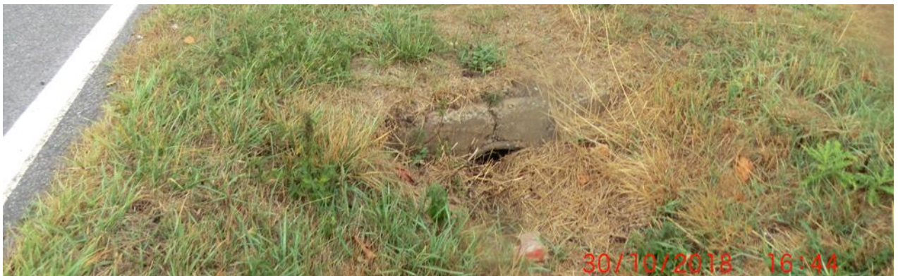
Abbildung 59: Bsp. Einlaufbauwerke mit Unterhaltungsbedarf
