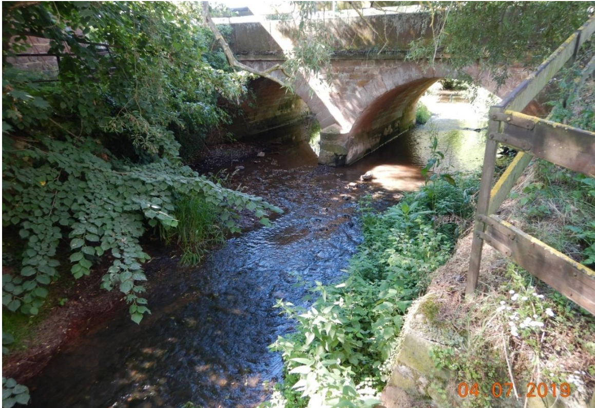
Abbildung 21: Bsp. unzureichende Gewässerunterhaltung
