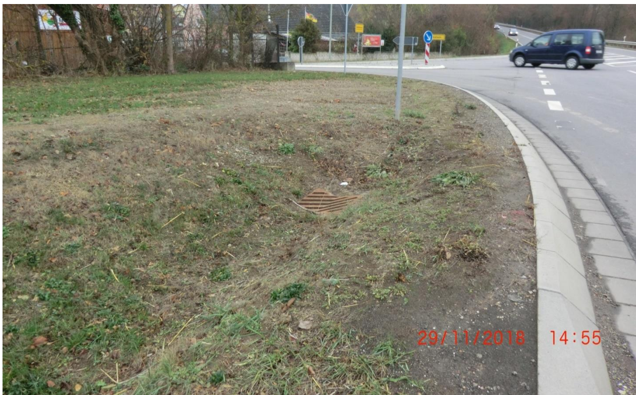
Abbildung 61: Bsp. Einlaufbauwerke mit Unterhaltungsbedarf f
