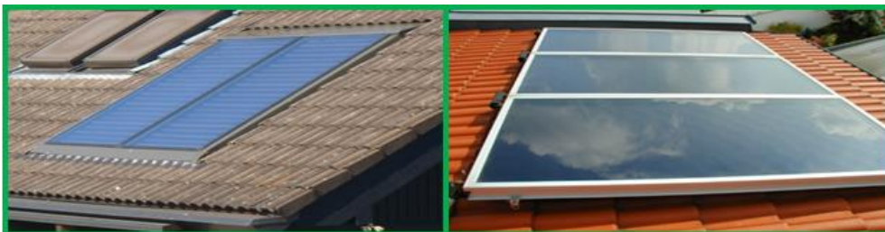
Sonnenkollektoren in (links) und auf (rechts) der Dachhaut
